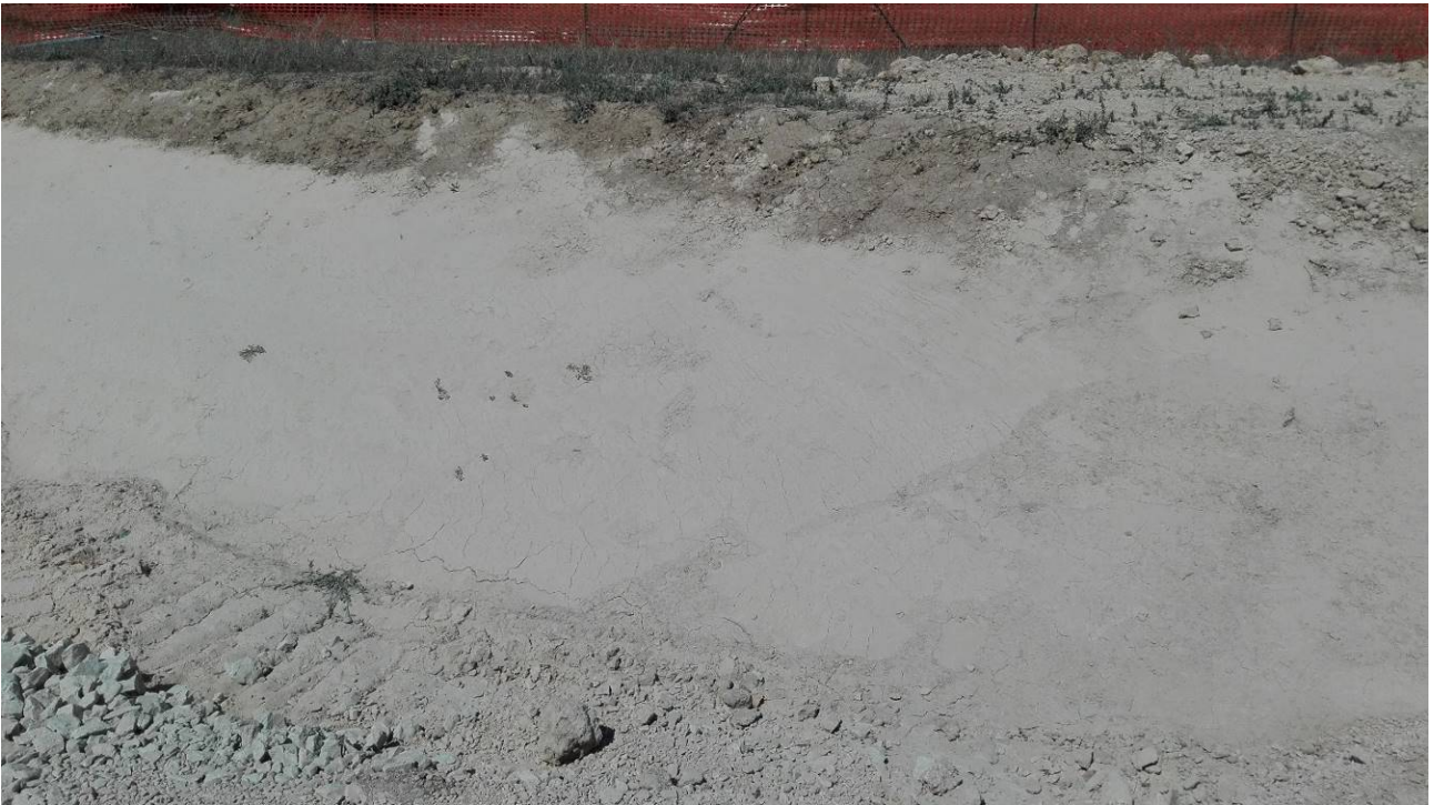
Foto 31 – Sabbie limoso-argillose (CLtf) affiorate durante l'esecuzione degli scavi di sbancamento per la realizzazione dell'area S.A.E.
