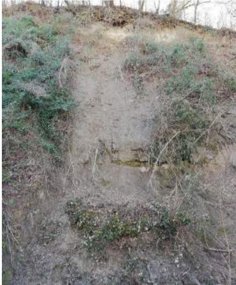
Foto 10 – Scarpata decisamente acclive con substrato affiorante. È determinante l'azione erosiva da parte del Fosso delle Conce.
